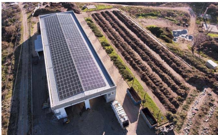
Slika 1 Fotonaponska elektrana na zgradi pretovarne stanice za otpad Treskavac, Krk. 9
