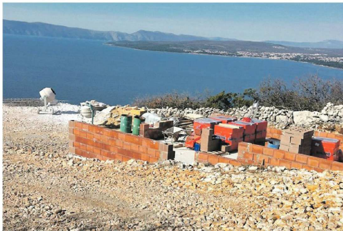
Jedna od dvije bespravne gradnje na potezu između Punta i Stare Baške, koju su inspektori Ministarstva graditeljstva upravo obišli – i zatvorili
